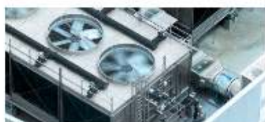
Køling og luftbehandling
